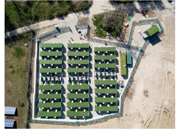
BESS: Sistema de almacenamiento de energía de batería
